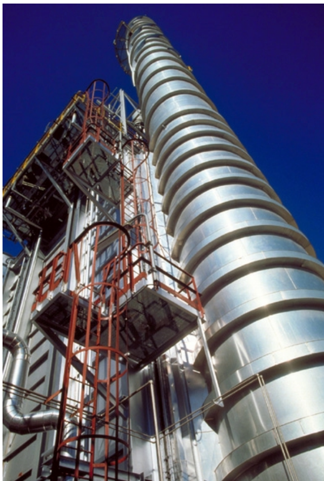
Refinería de CEPSA. Detalle.
