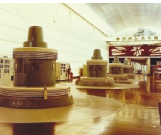
Central hidroeléctrica de Puente Bibey (foto cedida por UNESA).
